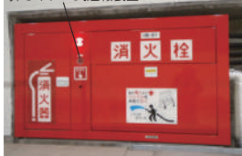
押しボタン式通報装置
