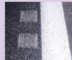
注意喚起溝 (路肩部)
