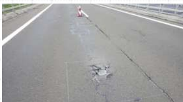
写真1 路面損傷状況
